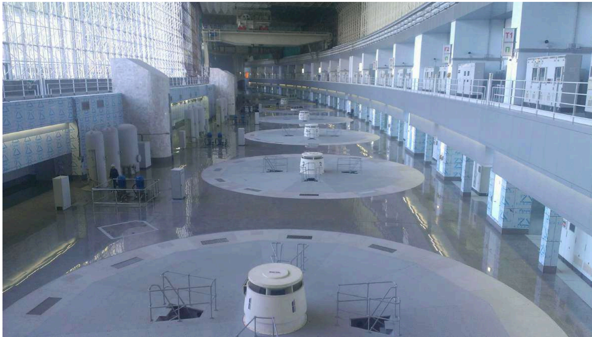
Машинный зал Саяно-Шушенской ГЭС, ПАО РусГидро
